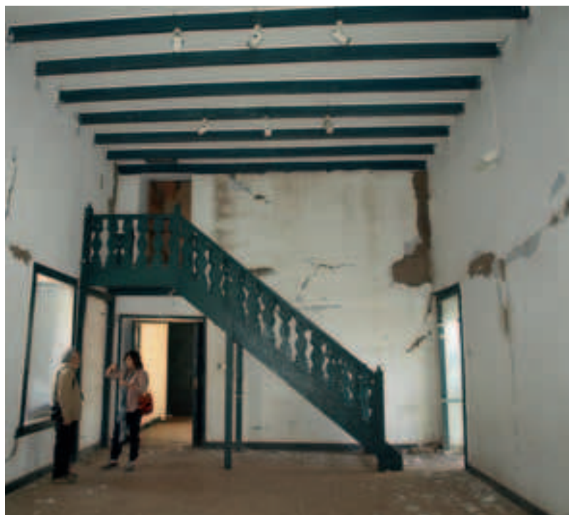
Foto 10: Vista de los daños en una de las salas de la Casa del Pilar de Esquina de Rancagua.
